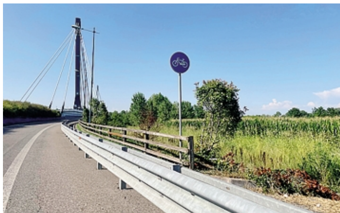
Il ponte tra Bertonico e Montodine: si può attraversare in bici Foto Scarioni
